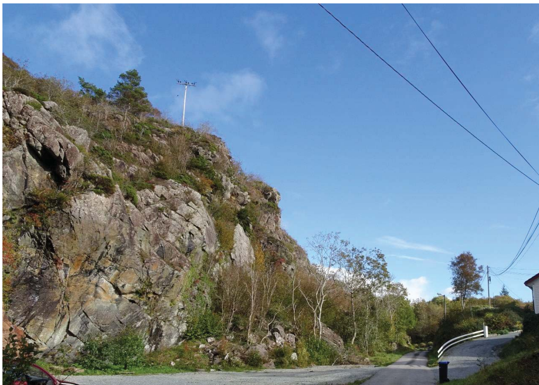
Bilde 3. Brattskrent med overheng og avløst berg i skrenten nord for planområdet. Legg merke til steinur mellom skrenten og vegen. Bildet er tatt mot øst.
